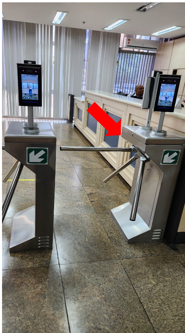
Imagem 4– Ausência de Sistema de detector de metais na entrada principal
